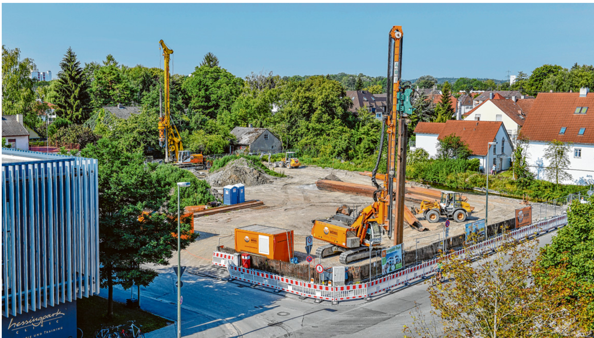
Baufahrzeuge haben begonnen, Spundwände für das Wohnprojekt „Singold-Park“ in den Boden zu rammen.
